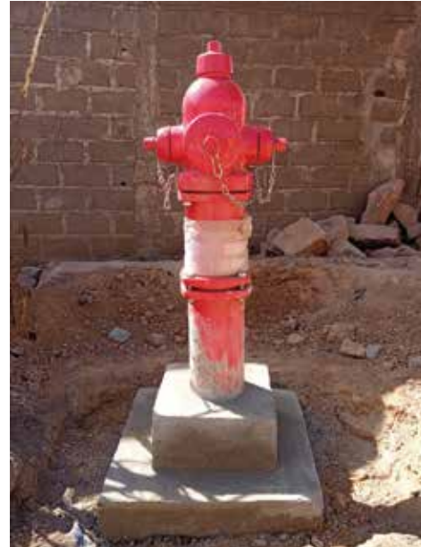
Poteau d'incendie /PAEP Bamako-Kabala/ Mali/2018-2021
