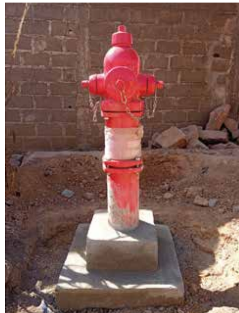
Poteau d'incendie /PAEP Bamako-Kabala/ Mali/2018-2021
